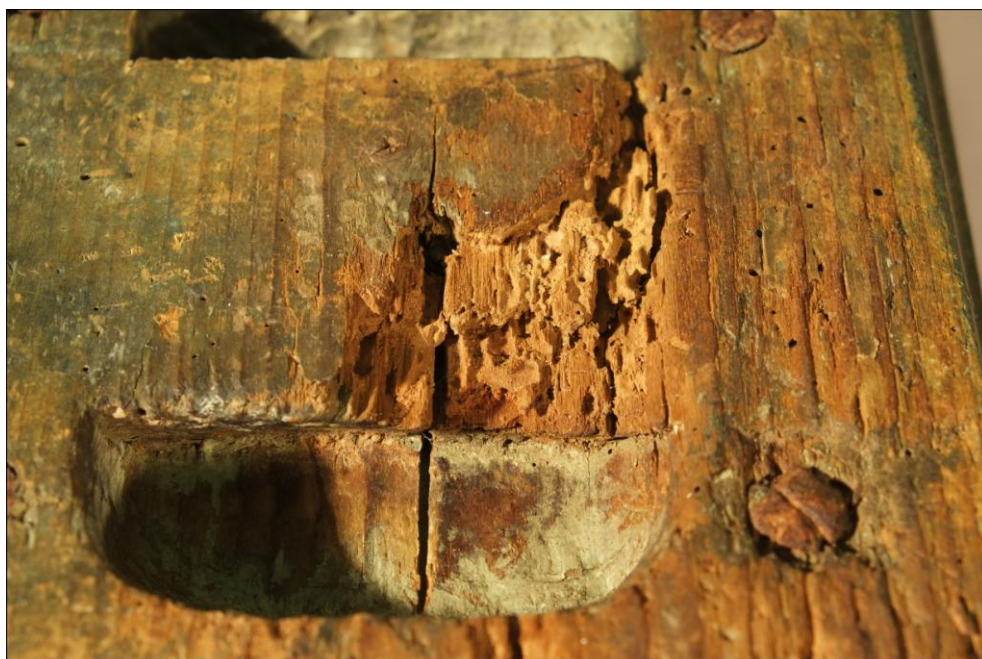
Obr. 77 Forma N 6765 Stav pred konzervovaním Detail poškodenia dreva
